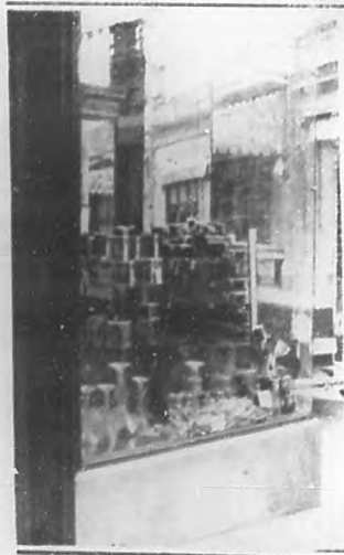
Una de las destrucciones del "Ten Cent", rota por un proyectil de arma de fuego.
